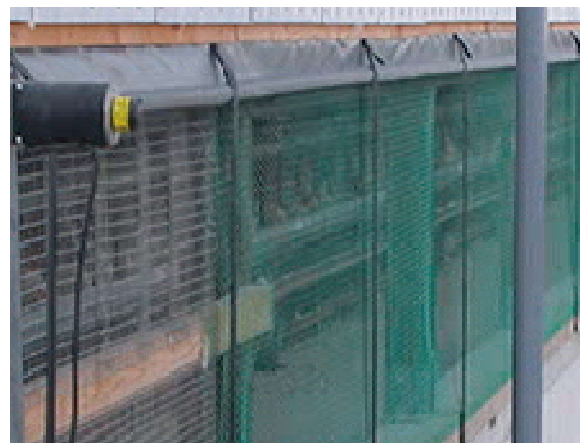
防鳥ネットの設置
